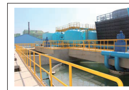
豐興鋼鐵新鋼筋工場循環水處理
