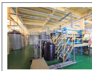
益通太陽能廠廢水處理工程
