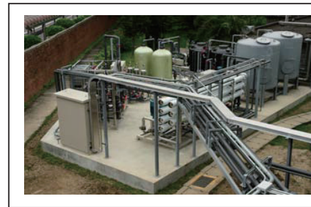
德州儀器超純水工程(RO+EDI)
